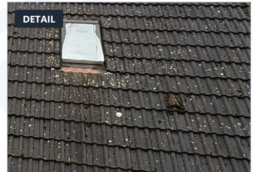
Detail rechts unterhalb des Dachfensters: Moos in den Fugen, Flechten als helle Punkte.
