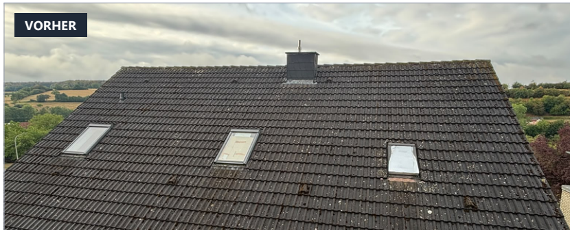
Gesamtansicht vor der Reinigung. Algen haben die Betondachsteine fast schwarz verfärbt.
