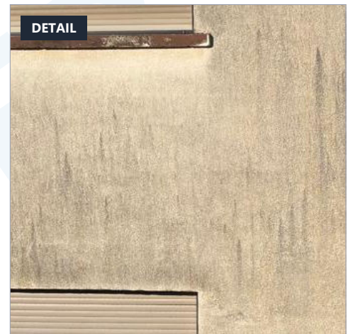
Detail zwischen den Fenstern: Laufspuren im Putz.
